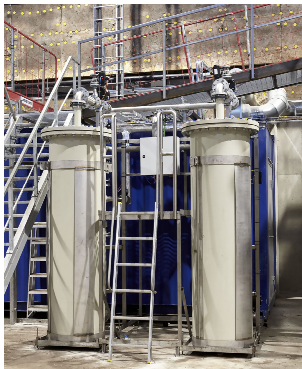
På bilden ses delar av det system för rening och recirkulation av processvatten som Axolot har levererat till Omni Polymers-anläggningen i Ängelholm.
