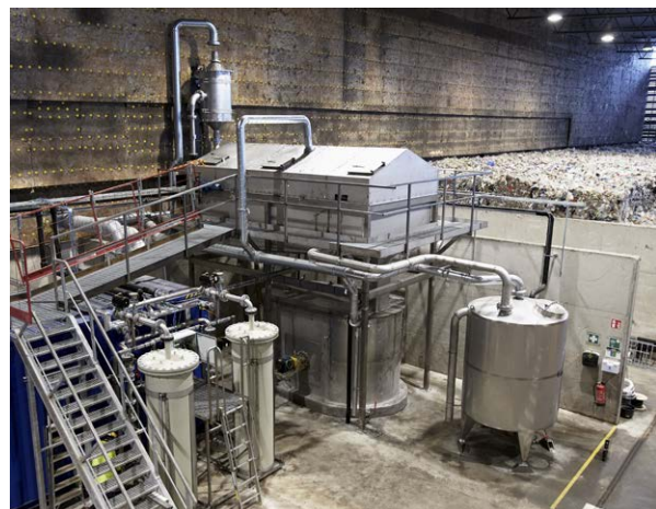
På bilden ses delar av det system för rening och recirkulation av processvatten som Axolot har levererat till Omni Polymers-anläggningen i Ängelholm.
