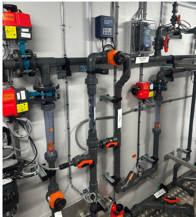
Flödesstyrning i en AxoPur containerenhet.
